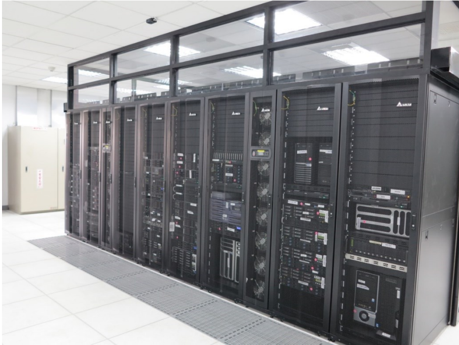
圖三、機房實體照片
