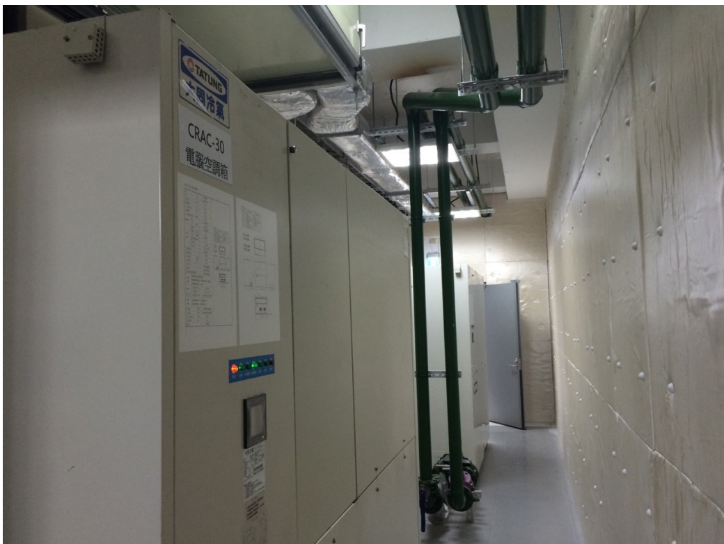
圖六、獨立空調室實體照片
