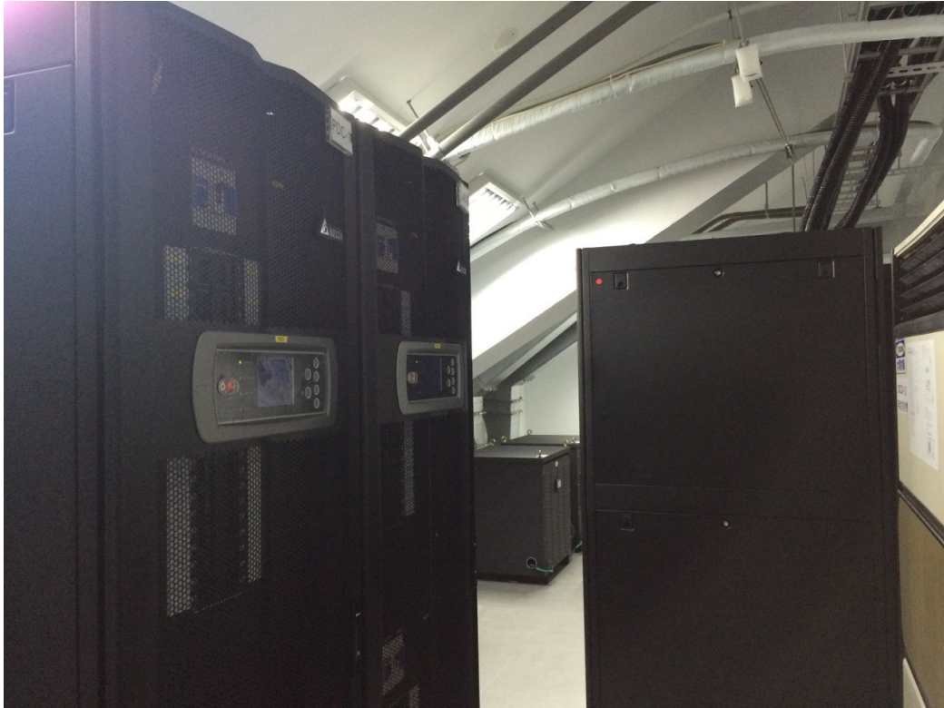
圖五、不斷電室實體照片
