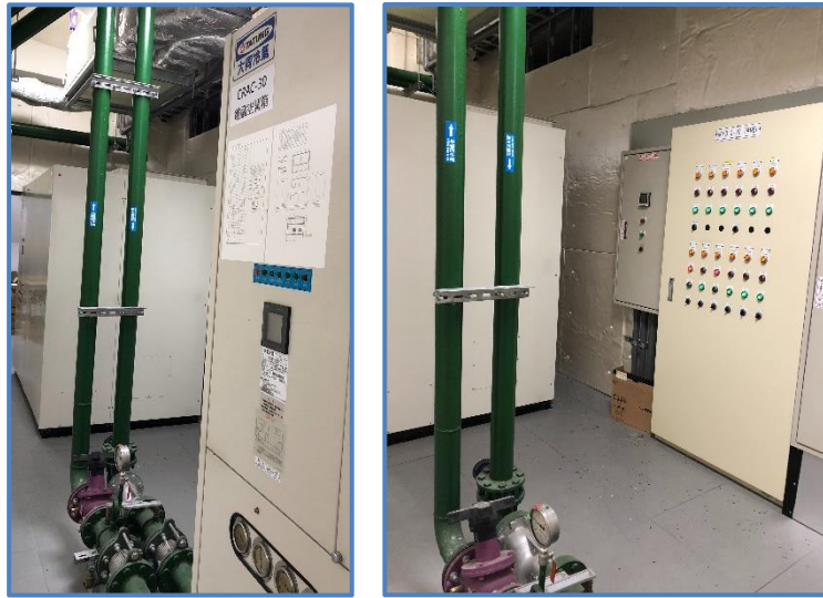
圖 6 獨立空調室實體照片(含冰水主機)
