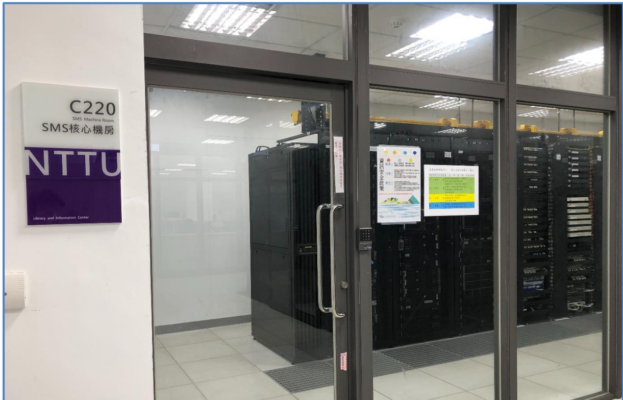
圖 4 ISMS 專區實體照片(核心系統機房)
