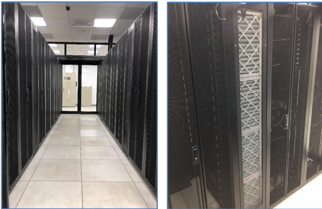
圖 7 獨立機櫃式冷熱通道空調系統(提供良好之 PUE 值)
